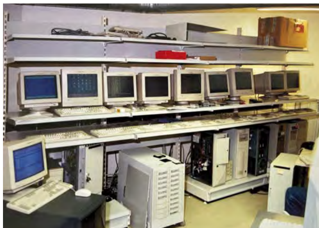
Blick in den Serverraum der KVN 1998. Die Digitalisierung ihrer Abläufe prägt die Arbeit der KVN seit den 90er Jahren.
